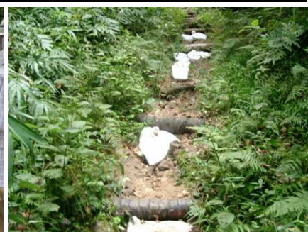
9/6 大雨で大きくえぐられた ゆうゆうの道(一部土嚢を設置)
